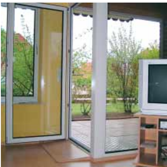
Auch mit kleinen Mitteln lässt sich ein beachtlicher Erfolg erzielen. Hier schafft ein nicht rostendes Stahlblech im Außenbereich sowie ein angepasster Holzkeil im Innenbereich die Barrierefreiheit.
