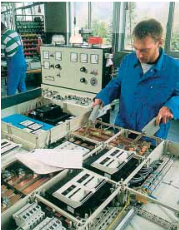
Montage einer Niederspannungsverteilungsanlage; Prüfung nach der Errichtung und vor Inbetriebnahme der Verteileranlage mit Dokumentation der Messergebnisse.
