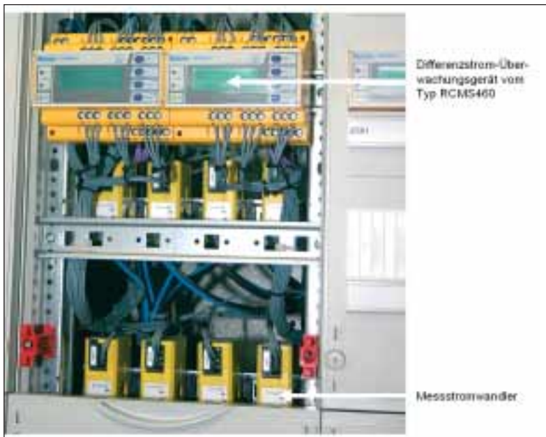
Isolationsüberwachungseinrichtung einer elektrischen Verteileranlage, bestehend aus Differenzstrom-Überwachungsgerät (RCMS) und Messwandler
