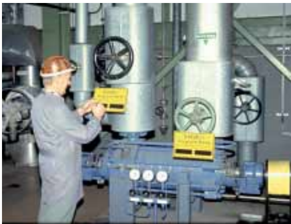
Vorbeugende Instandsetzung zur Sicherstellung der Betriebssicherheit; Pumpstation mit der Notwendigkeit einer störungsarmen elektrischen Energieversorgung.
