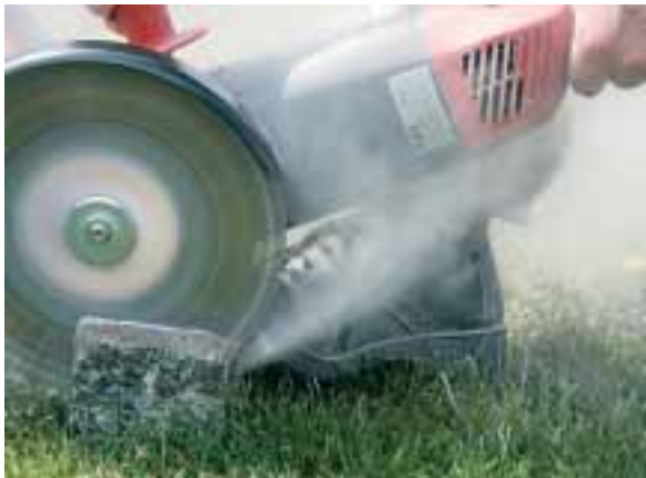
Schädigende Einwirkungen, wie z.B. leitfähiger Staub, haben eine Verkürzung der Prüffristen zur Folge.
